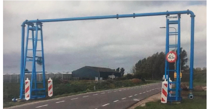
Afbeelding 2 voorbeeld van leidingbrug u de locatie van de brug, op afbeelding 2 een voorbeeld van een brug die elders is geplaatst.
