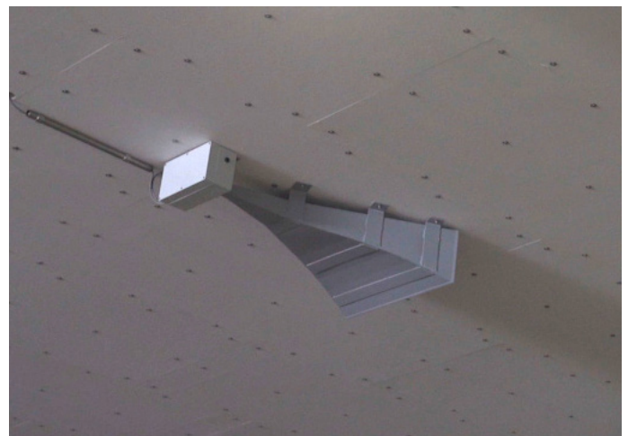
Afbeelding 2 Luidspreker in de Hollandtunnel
