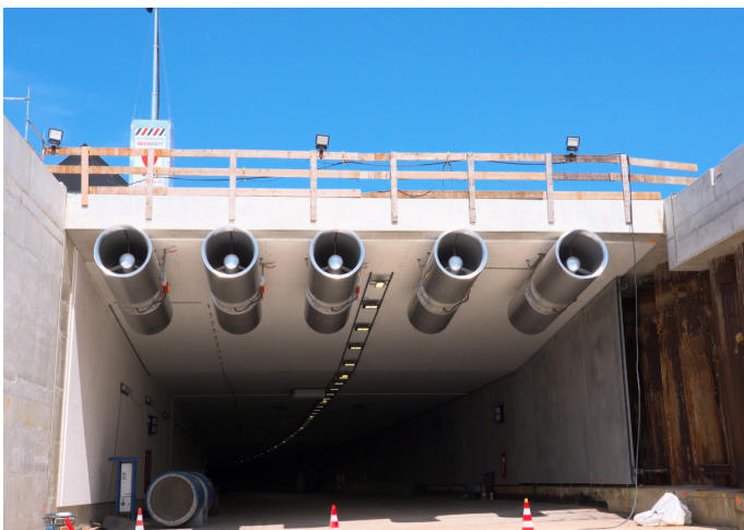
Afbeelding 1 Ventilatoren van de Hollandtunnel
